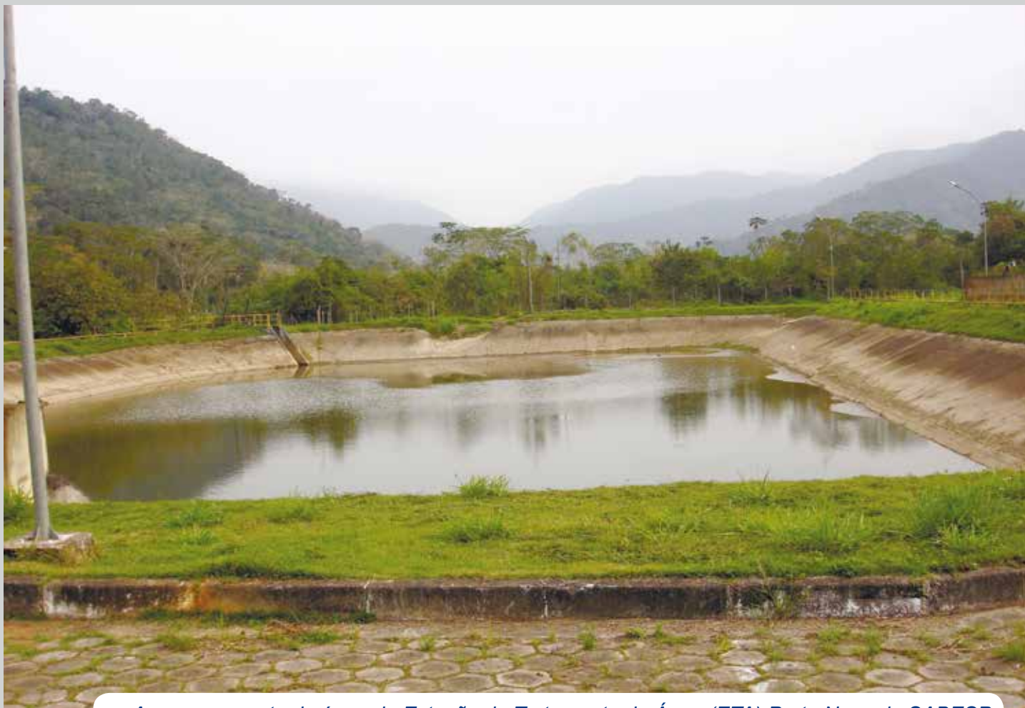
Armazenamento de água da Estação de Tratamento de Água (ETA) Porto Novo da SABESP
